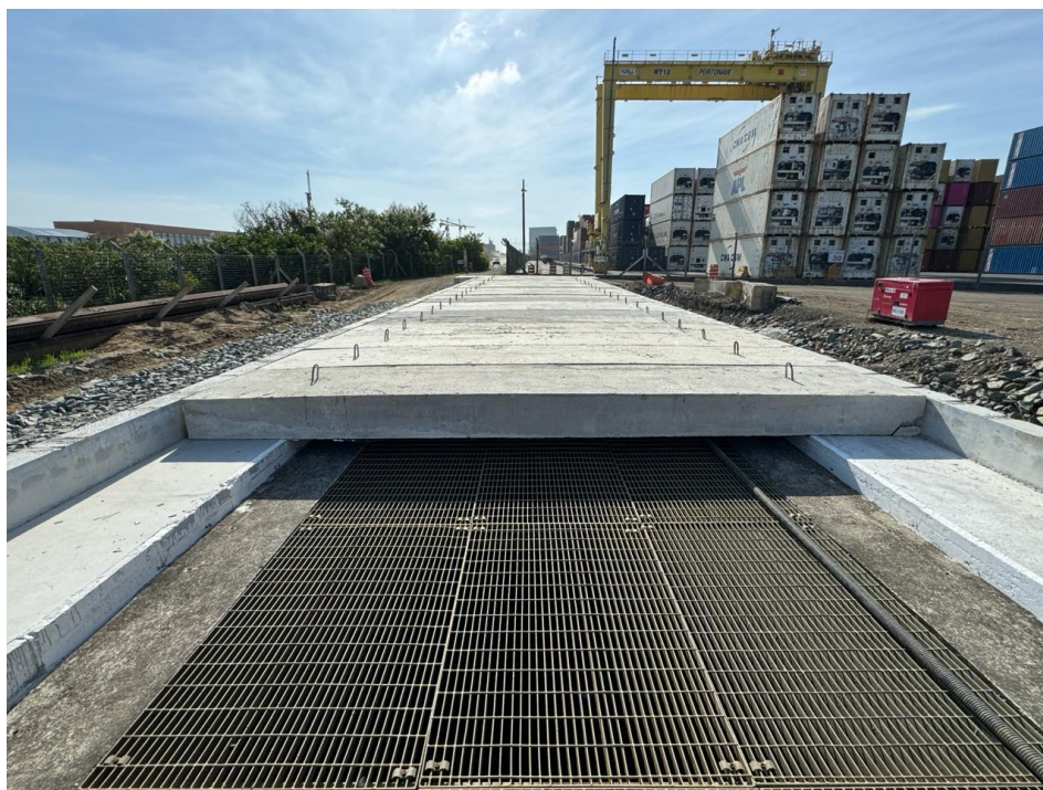
Canal de drenagem.
